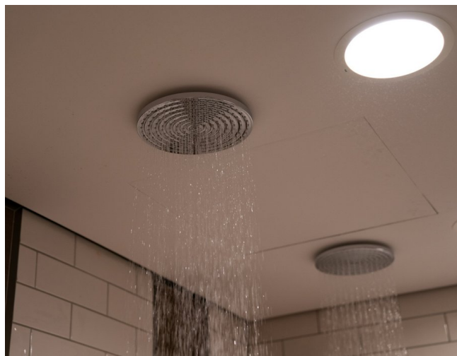
In der weitläufigen Badelandschaft sorgen die innovativen Duschanlagen von Hansgrohe für ein luxuriöses Duscherlebnis
